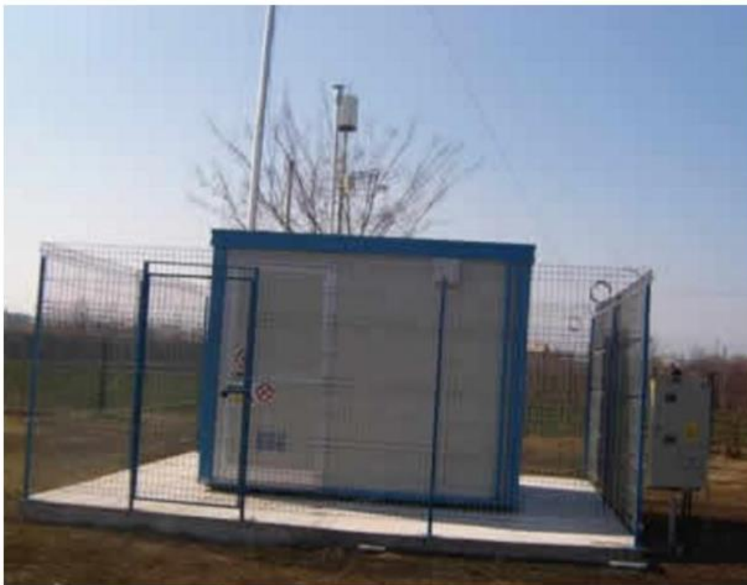
Figura nr. 2-11: Stația de fond rural VN-1
